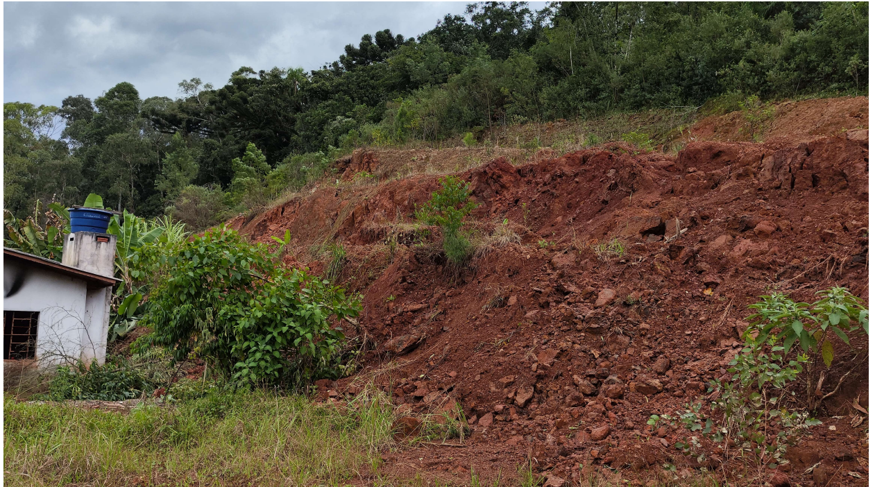
Foto dos fundos da residência próxima mostrando fortes evidências de novos deslizamentos.
